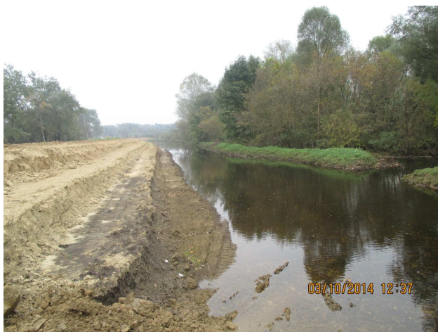
Stepenasto zasječen nasip, pripremljen za sanaciju između odrona i proboja u Račinovcima
